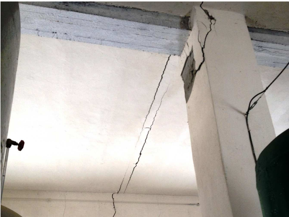
Fot. 12 - Widok zarysowań poprzecznych stropu oraz słupa
