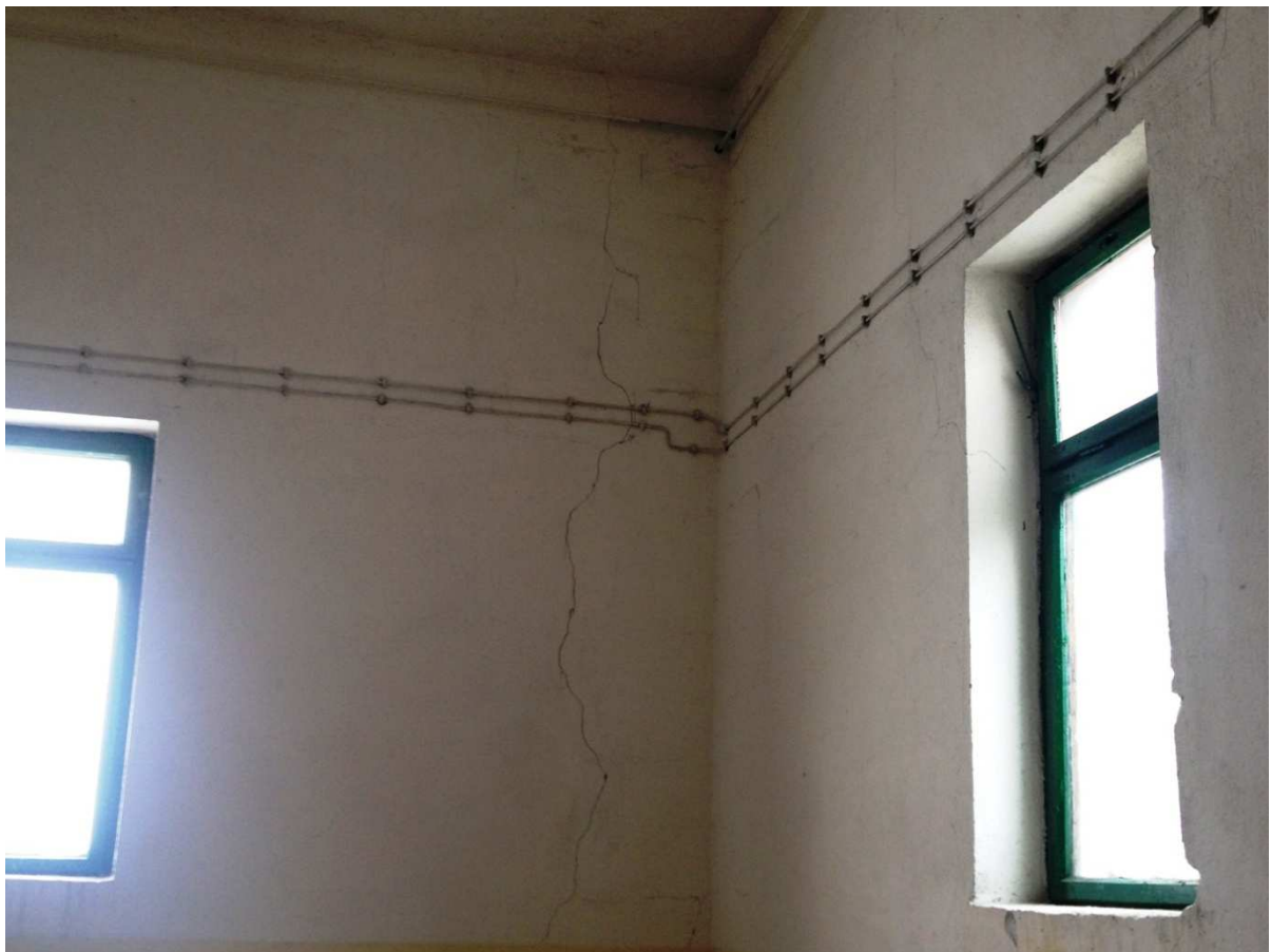
Fot. 14 - Widok pionowych zarysowań narożnika od strony północno-zachodniej
