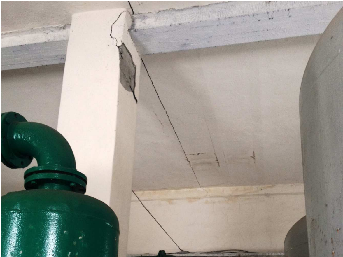
Fot. 11- Widok zarysowań poprzecznych stropu oraz słupa
