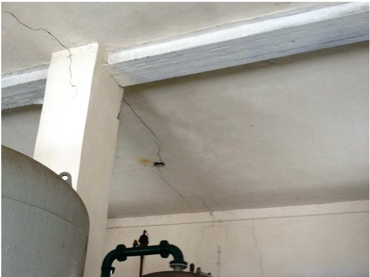
Fot. 13 - Widok zarysowań poprzecznych stropu oraz słupa
