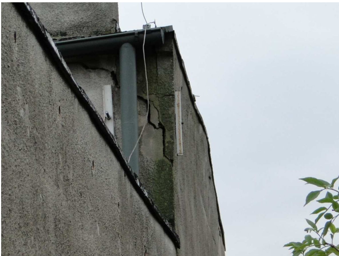
Fot. 2 – Widok spękanego narożnika elewacji od strony północno-wschodniej
