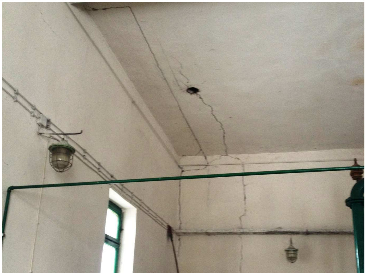
Fot. 15 - Widok pionowych i ukośnych zarysowań narożnika oraz pęknięć stropu od strony północno-wschodniej
